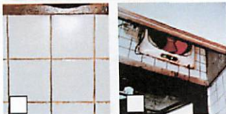
タイルの目地汚れ
